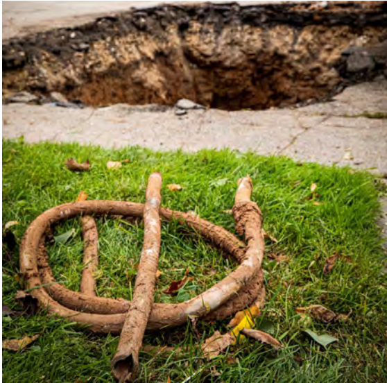
Tuberías de plomo
